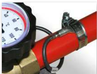
Figura 5: Collegamento della sonda a contatto sulla mandata
